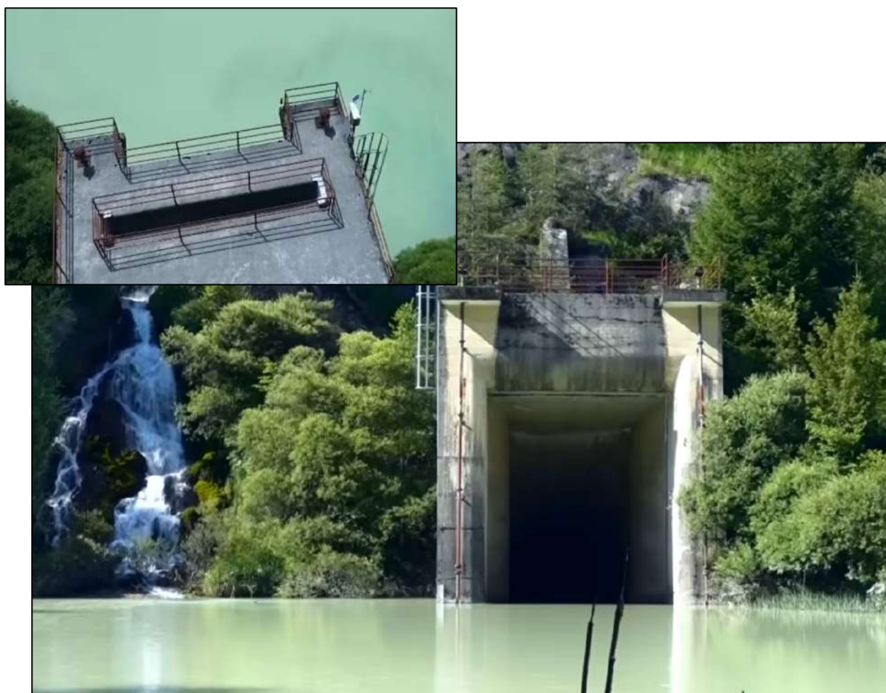
Figura 58: L'attuale imbocco galleria di by-pass posto a quota 635 m s.l.m. In evidenza particolari della struttura dotata di apposita sede per gargami nell'eventualità fosse necessario chiudere la derivazione.
