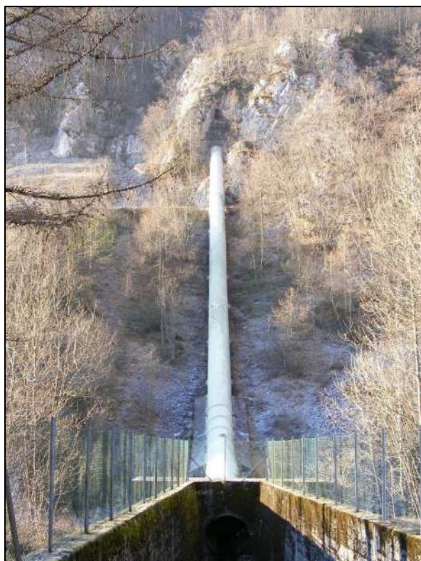
Figura 16: La tubazione di scarico della Galleria quota 721 m s.l.m. che scende dal Monte Cornetto.
