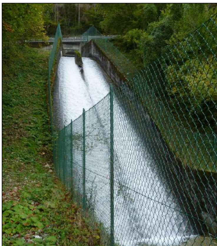
Figura 33: Lo scivolo di scarico che riversa nel Torrente Cimoliana.
